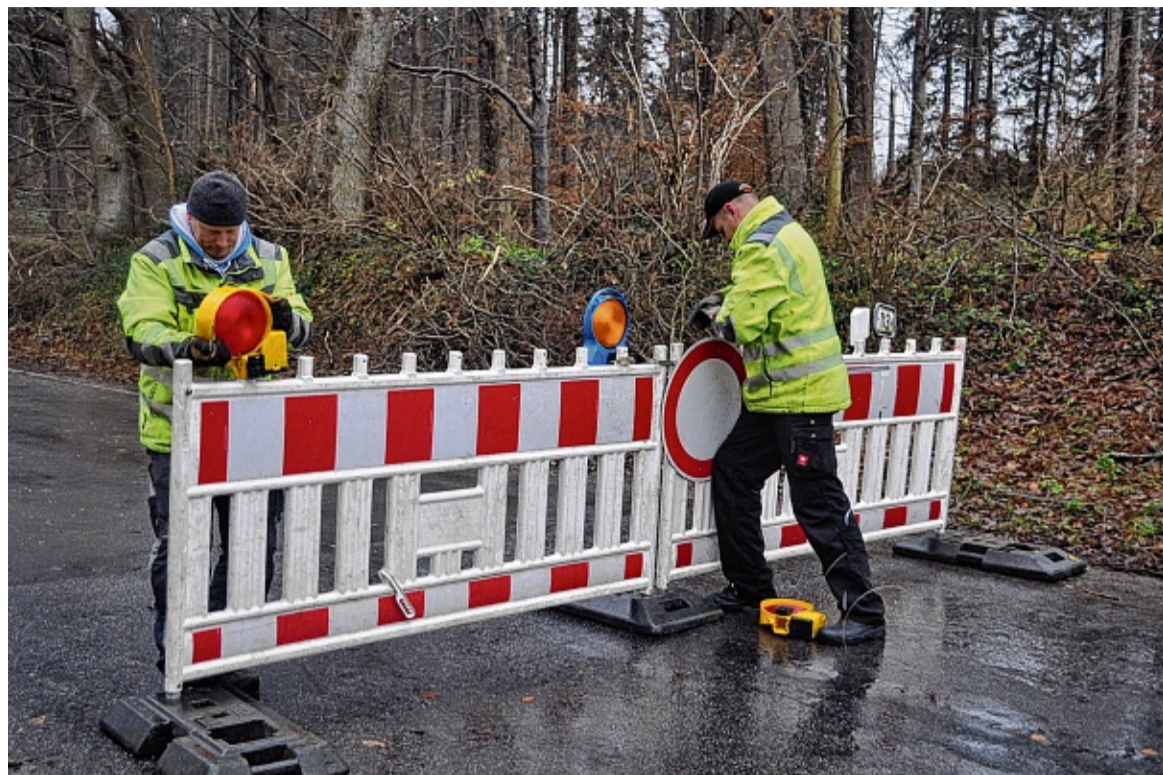
Die Gemeindearbeiter Andreas Hammerich (l.) und Bernd Grothkopp sperrten gestern gegen 13 Uhr die Kreisstraße 54 von Fleckeby/Pütscherstraße bis zur Straße Damm. Bereits bei Sturmflut „Christian“ wurde die Straße mehrfach durch umgestürzte Bäume und gebrochene Äste blockiert. MESSERSCHMIDT
