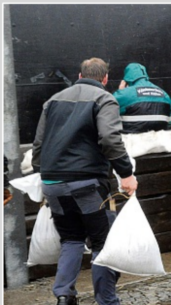
Sandsäcke und zusätzliche Dalben: Mitarbeiter des Küstenschutzes sichern im nordfriesischen Dagebüll die Fluttore.
